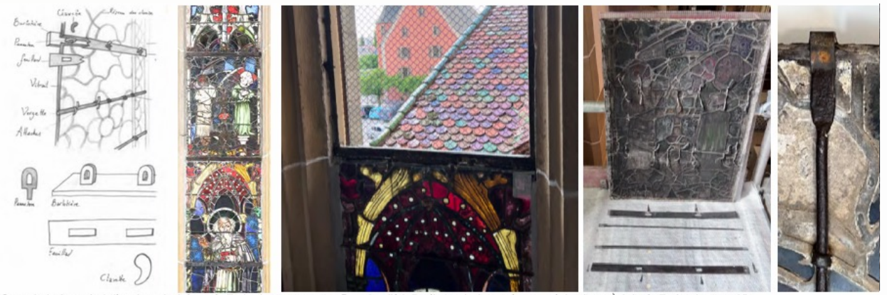
Serrurerie de vitraux : barbotières, barre de chaînage, feuillards, clavette et vergettes. Exemple « d'échelle céleste » des barres où sont posés les vitraux. À droite, feuillard et clavette mobiles. À droite (dernière photo, vergette verticale pincée sur le panneau. Ce dispositif de vergettes (horizontale en intérieur et verticale en extérieur) garantit une très bonne conservation mécanique du panneau.
