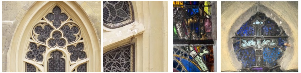
Réseau de la baie 8 / détail d'un désordre de pierre en bas à droite de la photo.
